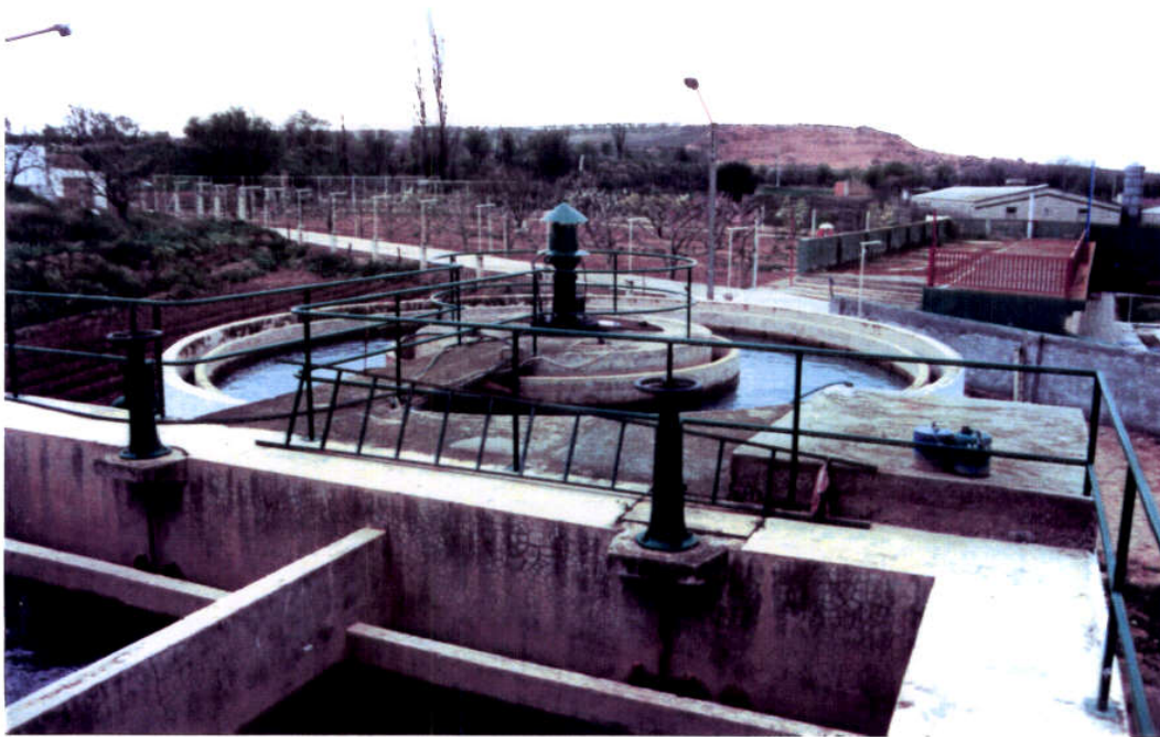
FOTO 2: Planta potabilizadora de las aguas del Canal de Lodosa.
